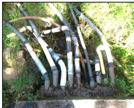
Figura 9. Acueducto comunitario barrio carambolas febrero 2012 O. G. Anderson
